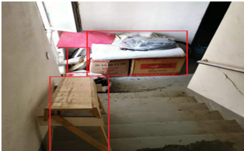
图 3-8 消防通道占用检测 2
