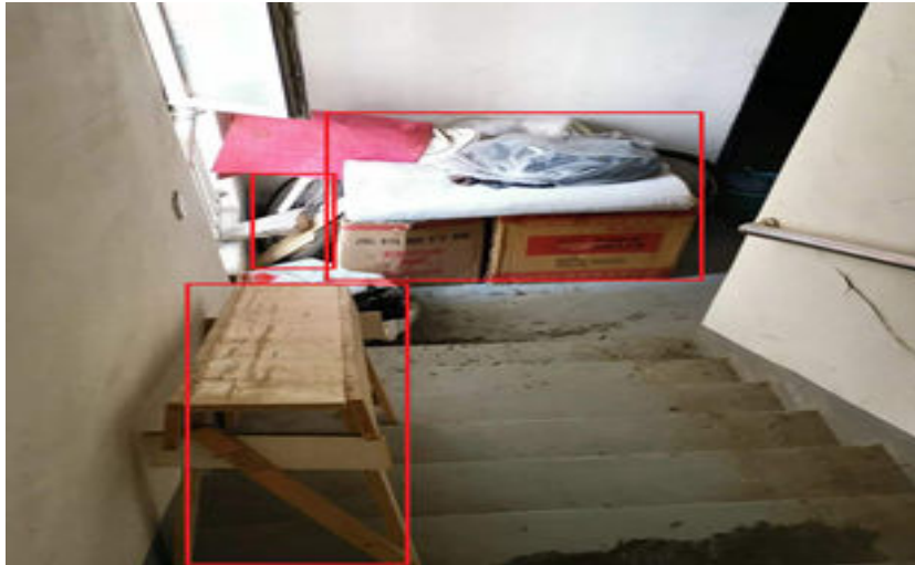
图 3-8 消防通道占用检测 2
